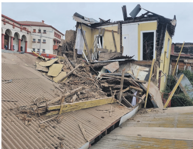
Gran parte de la vivienda ubicada en la zona típica de La Serena se derrumbó durante la mañana de ayer. No hubo transeúntes lesionados y la vivienda estaba deshabitada.
