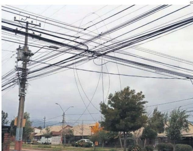
EL DELITO NO SÓLO AFECTA LAS INSTALACIONES DE LA COMPAÑÍA, SINO TAMBIÉN A SUS CLIENTES.
