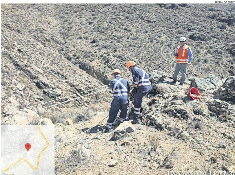
BRIGADISTAS DE ENGE, COOPERSOL Y CONTRATISTAS TRABAJABAN AYER PARA RESTABLECER EL SERVICIO ELÉCTRICO.
