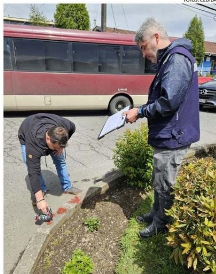
MARCACIÓN VIAL PARA SEMÁFORO EN CHONCHI.
