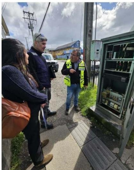
REVISIÓN DE CONTROLADOR DE SEMÁFORO EN QUELLÓN.
