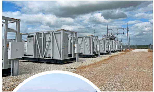
Imagen referencial de Sistemas de Almacenamiento (BESS).
