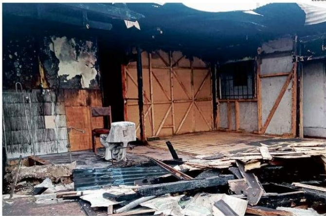
EL INMUEBLE QUEDÓ CONVERTIDO EN RUINAS Y AHORA EL AFECTADO NECESITA RECONSTRUIR.
