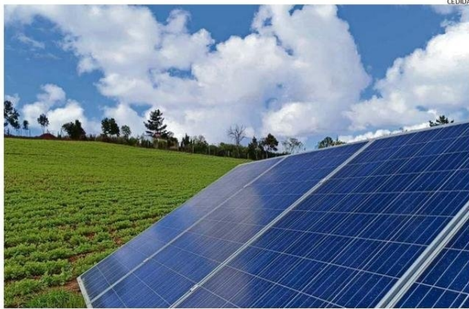
EN LA REGIÓN DESTACA PROYECTO QUE COMBINA USO DEL SUELO CON GENERACIÓN FOTOVOLTAICA.
