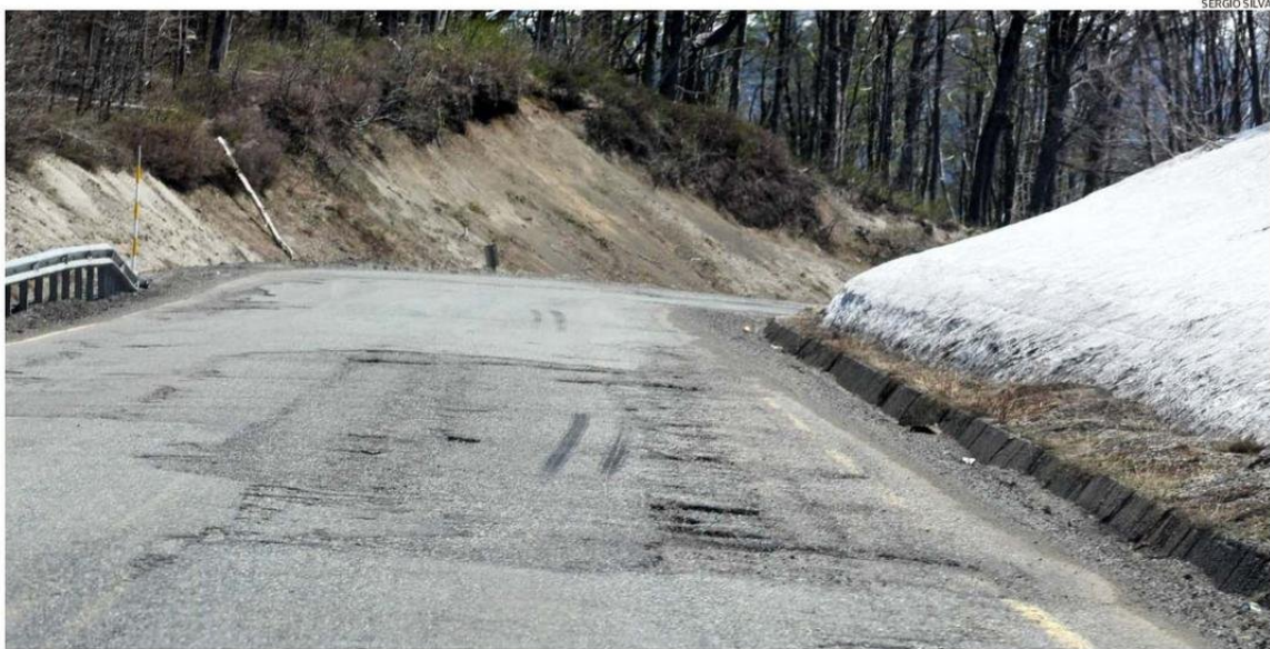
HAY ZONAS DONDE AMBAS PISTAS ESTÁN EN MAL ESTADO Y LOS VEHÍCULOS DEBEN ESQUIVAR LOS “EVENTOS”. SE HAN REALIZADO TRES LICITACIONES FALLIDAS PARA SU REPARACIÓN.
