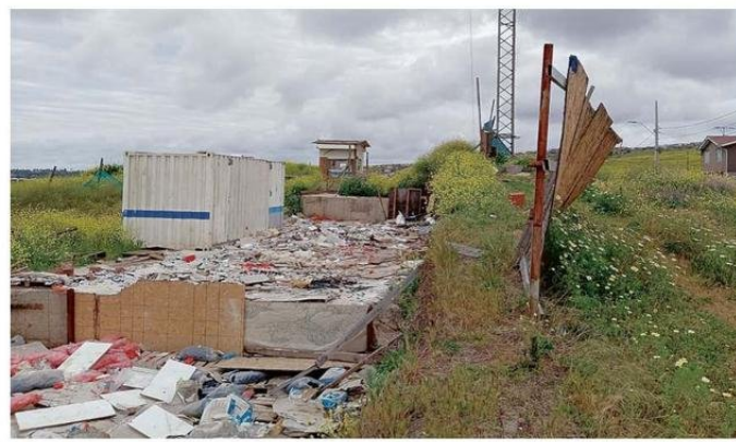
LAS INSTALACIONES ABANDONADAS SON UN FOCO DE CONSTANTE PREOCUPACIÓN PARA LOS VECINOS.
