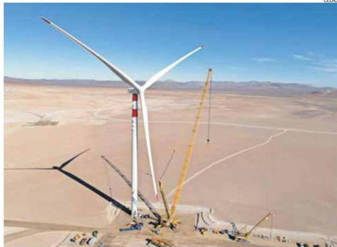
EL PROYECTO EÓLICO DE ENGIE EMPLAZADO EN LA COMUNA DE TAL TAL, CONSIDERA 57 AEROGENERADORES.
