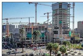
Los labores de construcción del conjunto inmobiliario Egaña Comunidad Sustentable fueron retomadas.
