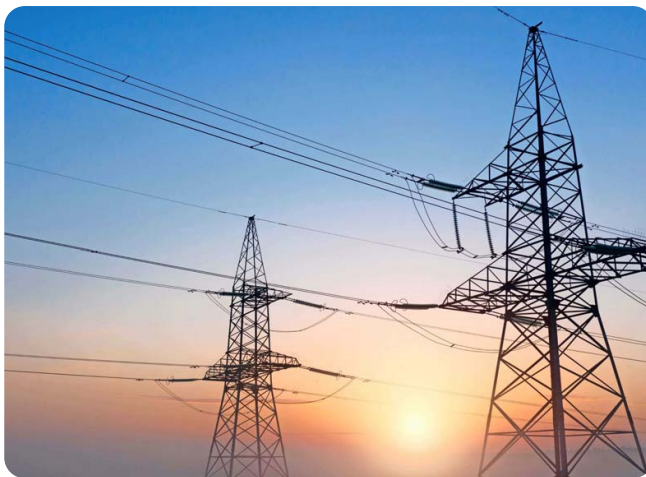
La infraestructura tiene que ser capaz de introducir cambios tecnológicos que le permitan ser un sector habilitante para la transición energética.
