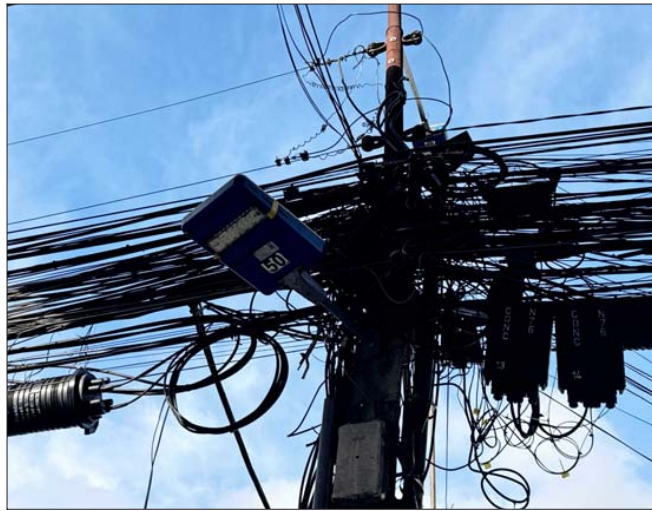
UNA POSTAL RECURRENTE DE NORTE A.—sur. Las empresas instalan los cables, pero no los retiran. Este ejemplo corresponde a Concepción.
