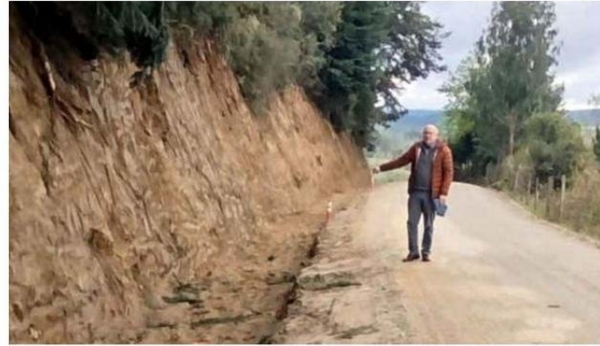
EN LA IMAGEN SE VE PARTE DEL MEJORAMIENTO PREPARATORIO DE LA VÍA U-300, DE CARA A SU ASFALTADO.
