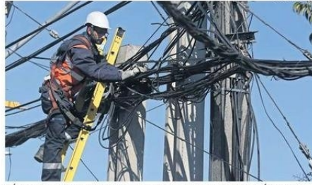
SÓLO EN ANTOFAGASTA FUERON DERRIBADOS 157 POSTES ELÉCTRICOS.
