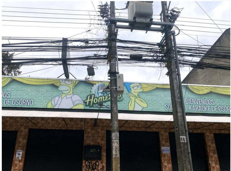
ESTAS CANTIDADES DE CABLES ENREDADOS Y SUELTOS SE PUEDEN VER EN TODOS LOS PUNTOS DE LA CIUDAD, EN ESPECIAL EN LA ZONA CENTRO.
