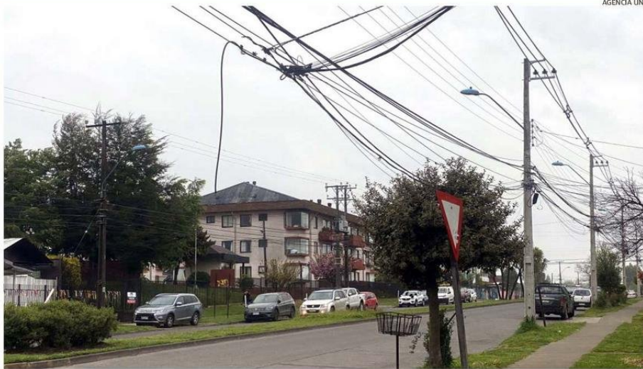
LOS CABLES VAN CAYENDO POR EL PESO Y MUCHAS VECES SON ENGANCHADOS POR LOS CAMIONES QUE PASAN, VOTANDO POSTES Y CORTANDO LA LUZ.
