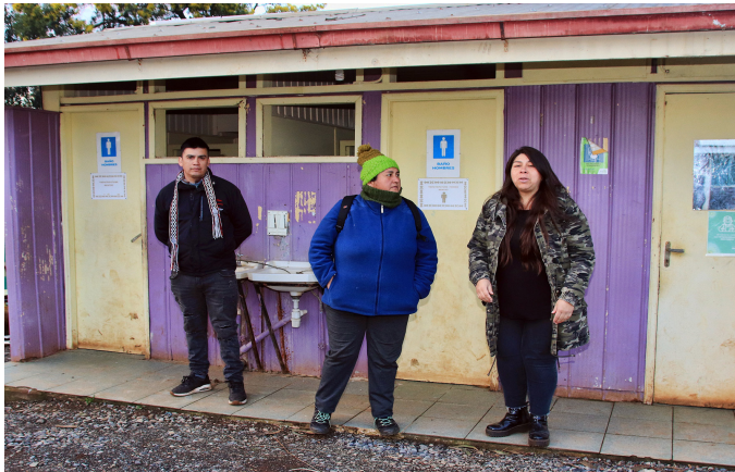
Baños en mal estado, inexistencia de agua potable y una serie de situaciones similares denunciaron los apoderados de la escuela.
