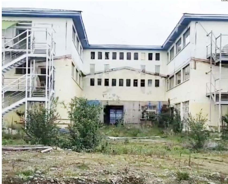
ASÍ LUCEN LAS INSTALACIONES ACTUALMENTE, TOTAL ABANDONO Y DONDE LOS ROBOS SON PARTE DEL DETERIORADO DEL EMBLEMÁTICO LICEO.
