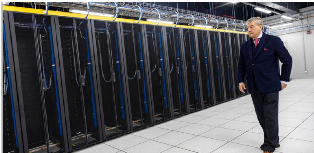
El presidente de GTD, Manuel Casanueva, en el data center inaugurado este jueves en el barrio Lu-rín, de Lima, en Perú.
