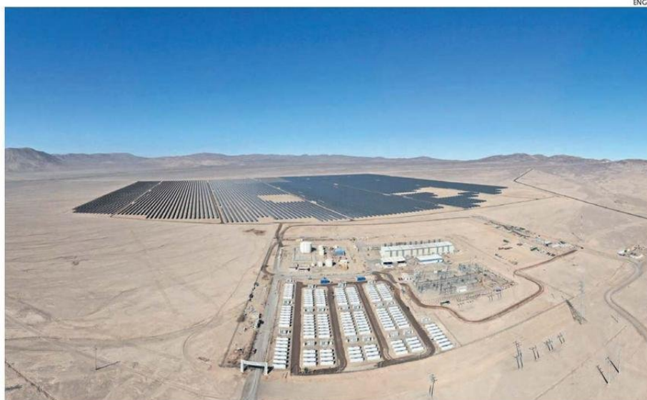
PROYECTO CUENTA CON 152 CONTENEDORES DE BATERÍAS CARGADOS CON ENERGÍA GENERADA POR LA PLANTA SOLAR TAMAYA.
