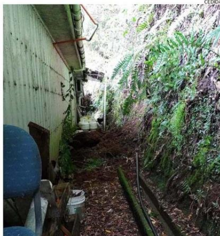
FOTOS VIRALIZADAS AYER MUESTRAN LA DIMENSIÓN DEL DESLIZAMIENTO.
