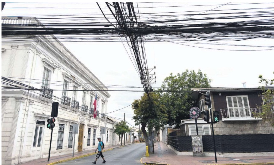
La seremi de Transportes y Telecomunicaciones aclaró que es responsabilidad de las empresas el retiro de cables, pero están a la espera del visto bueno del reglamento.
