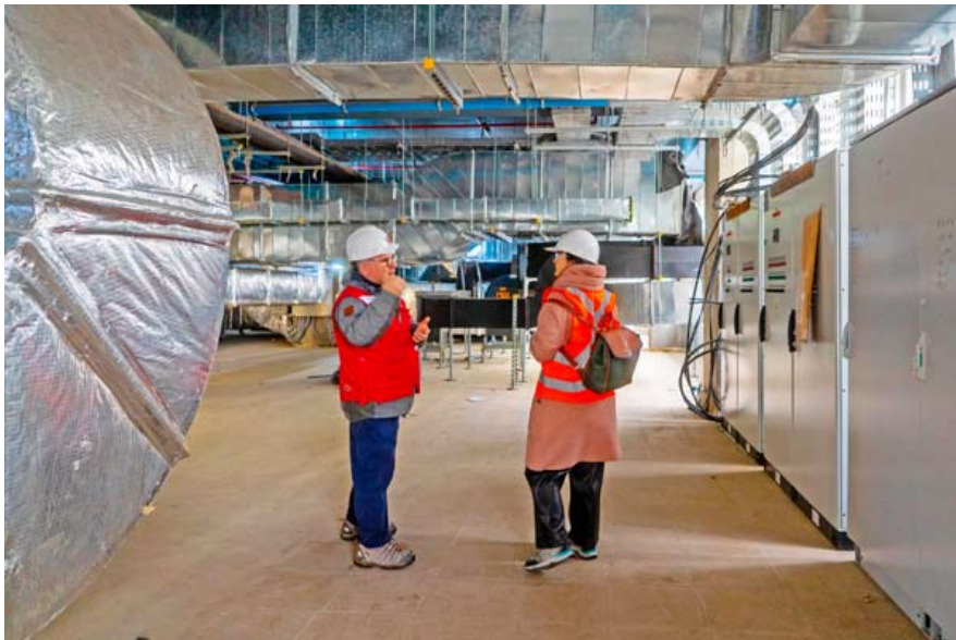
La central está ubicada en el tercer piso de cada una de las torres.
