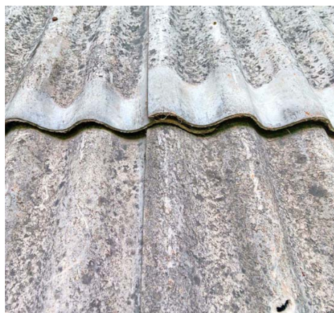
En Chile está prohibida la producción, importación, distribución y venta de materiales que contengan cualquier tipo de asbesto.
