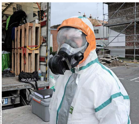
La remoción de asbesto se debe realizar de manera muy cuidadosa por las enfermedades respiratorias que se pueden generar al inhalar el material.
