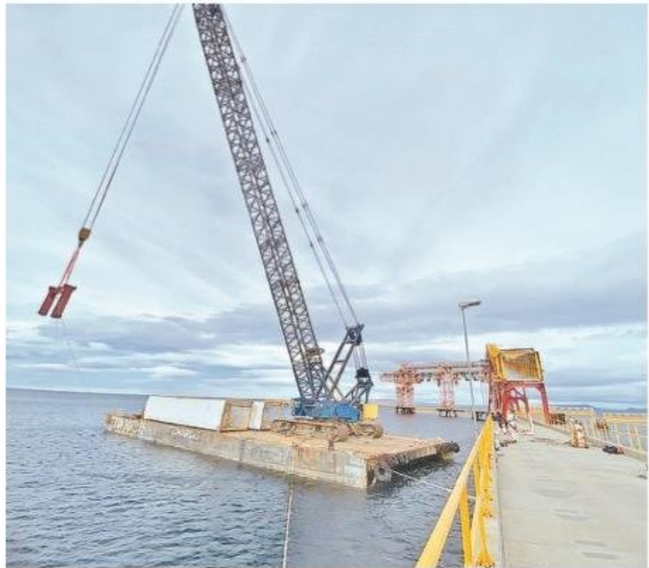
La barcaza y grúa donde ocurrió el accidente en el terminal marítimo de Mina Invierno.
