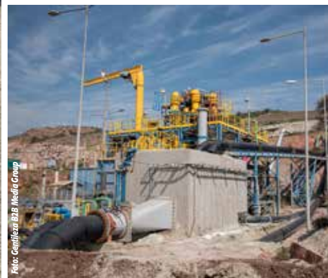
Sistema de ciclones e impulsión de arena.
