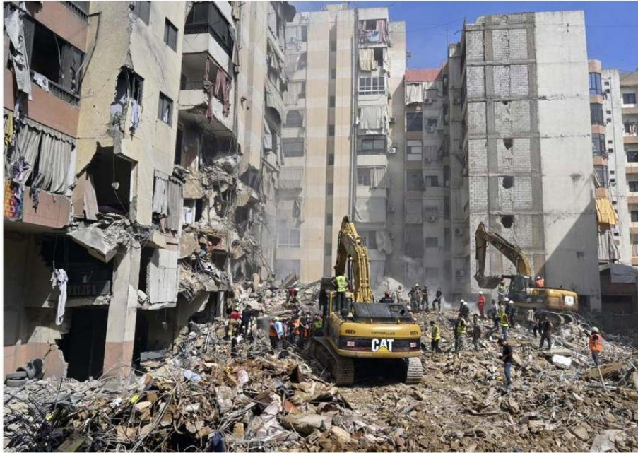
CON EXCAVADORAS LIMPIABAN AYER LOS ESCOMBROS EN EL LUGAR QUE FUE BLANCO DEL ATAQUE ISRAELÍ EL VIERNES, EN EL SUBURBIO AL SUR DE BEIRUT.
