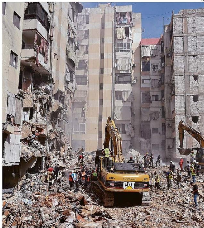
CON EXCAVADORAS LIMPIABAN AYER LOS ESCOMBROS EN EL LUGAR QUE FUE BLANCO DEL ATAQUE ISRAELÍ.
