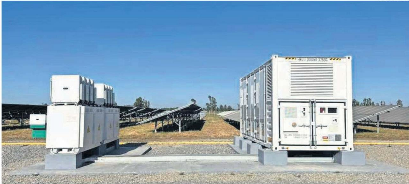
EL PROYECTO DE SISTEMA DE ALMACENAMIENTO DE ENERGÍA Y LÍNEA DE TRANSMISIÓN BESS PUEBLO HUNDIDO, TIENE UNA INVERSIÓN DE 400 MILLONES DE DÓLARES Y SU FECHA DE INICIO DE EJECUCIÓN SERÍA OCTUBRE DEL 2026.
