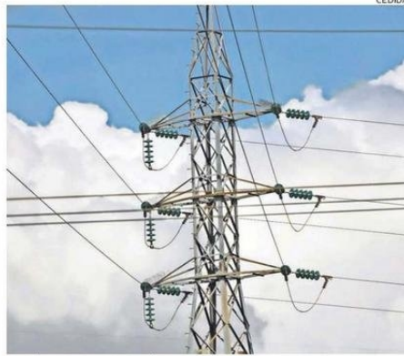
LAS LÍNEAS DE TRANSMISIÓN SON CLAVE PARA EVITAR EL VERTIMIENTO.
