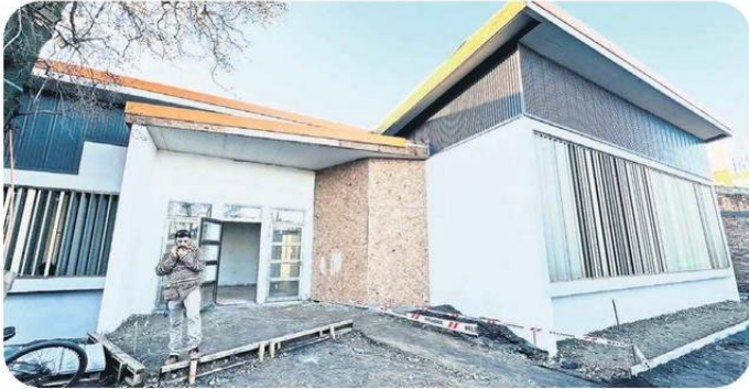
Un 85 por ciento de avance presenta la construcción del Centro Comunitario de Participación y Formación Social, cuya inversión alcanza los $713 millones, provenientes del Gobierno Regional, y que está ubicado en calle Fernando Urrea, sector Altos de Chiguayante.
