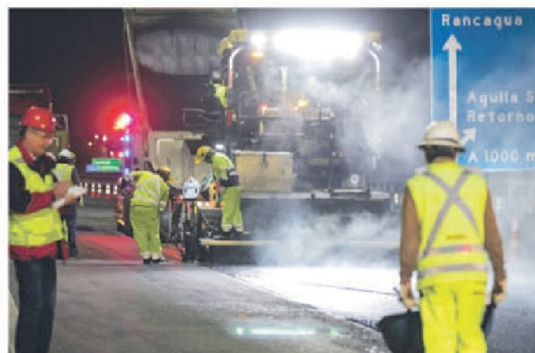
Proyecto "Fityre" ha permitido un asfaltado "verde" en Ruta del Maipo, demostrando que la fibra textil de neumático fuera de uso es una alternativa sostenible para la industria.
