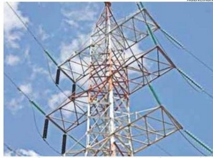
AUMENTARÁ LA CAPACIDAD DE TRANSPORTAR ENERGÍA DE LA REGIÓN.
