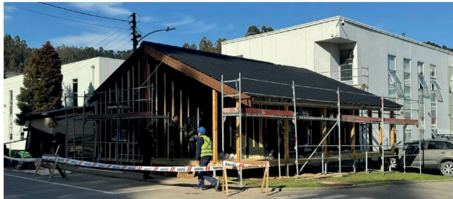
EN TÉRMINOS DE EFICIENCIA ENERGÉTICA, el prototipo tiene como objetivo un ahorro del 80% en comparación con viviendas convencionales.
