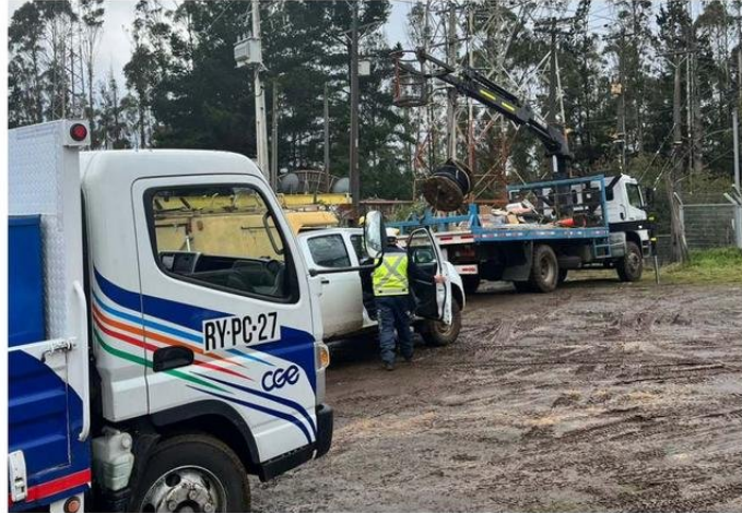
LOS PRÓXIMOS DÍAS DEBERÍA REPONERSE EL SERVICIO TAL Y COMO ESTABA DE FORMA AÉREA.
