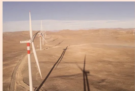
Parque Eólico Horizonte, Colbún S.A.
