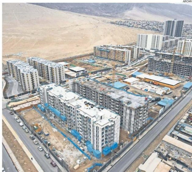
LA MAYOR PARTE DE LOS PROYECTOS SE ENCUENTRAN UBICADOS EN LA MACRO URBANIZACIÓN DE LA CHIMBA.
