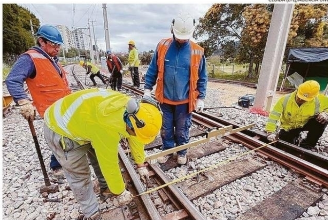
TRABAJOS, QUE TIENEN POR OBJETIVO REPARAR LAS VÍAS, SE ESTÁN REALIZANDO EN ZONA DE VALENCIA.
