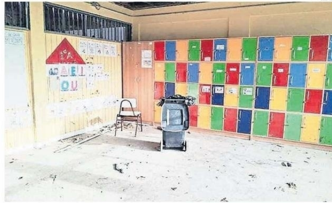
DAÑO EN LA TECHUMBRE DE UNA DE LAS SALAS, ADEMÁS DE HUMEDAD, SON ALGUNOS DE LOS DRAMAS.
