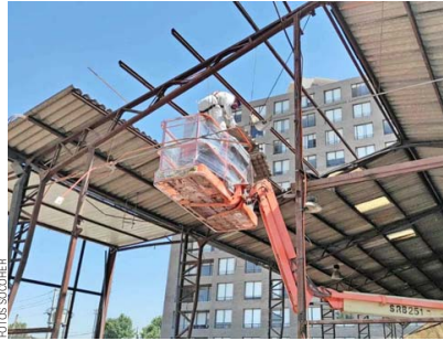
Socoher puede manejar el asbesto en diferentes tipos de construcciones, como galpones.
