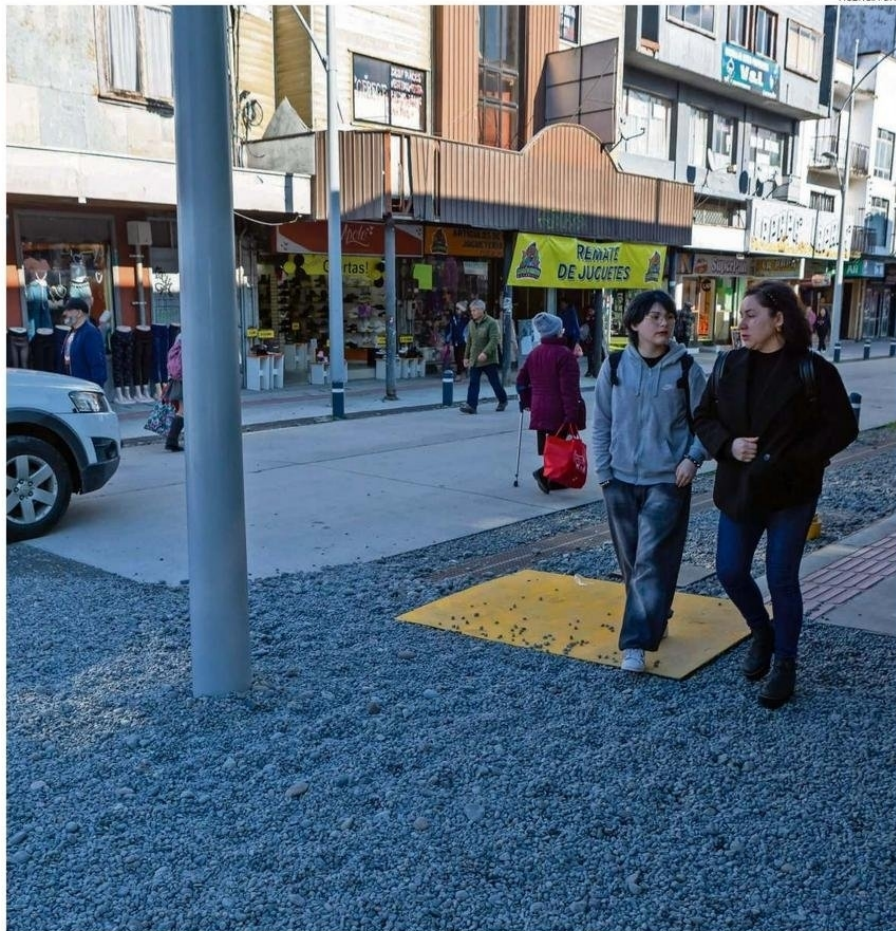
TRAS LA QUIEBRA DE LA CONSTRUCTORA COSAL, LAS OBRAS QUEDARON ABANDONADAS A CONTAR DE JULIO DEL AÑO PASADO.
