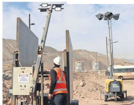
EL EQUIPO SOLAR CUENTA CON SEIS PANELES DE 315 WATTS.
