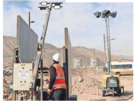
EL EQUIPO SOLAR CUENTA CON SEIS PANELES DE 315 WATTS.
