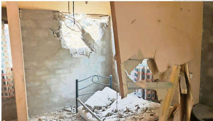
LA CAÍDA DE ROCAS EN ALTO DEL CARMEN DESTRUYÓ PARTE DE UNA VIVIENDA. LA FAMILIA EVACUÓ ANTES.
